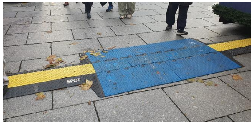
Príklad bezbariérového prekonávania dočasných rozvodov elektrických vodičov
